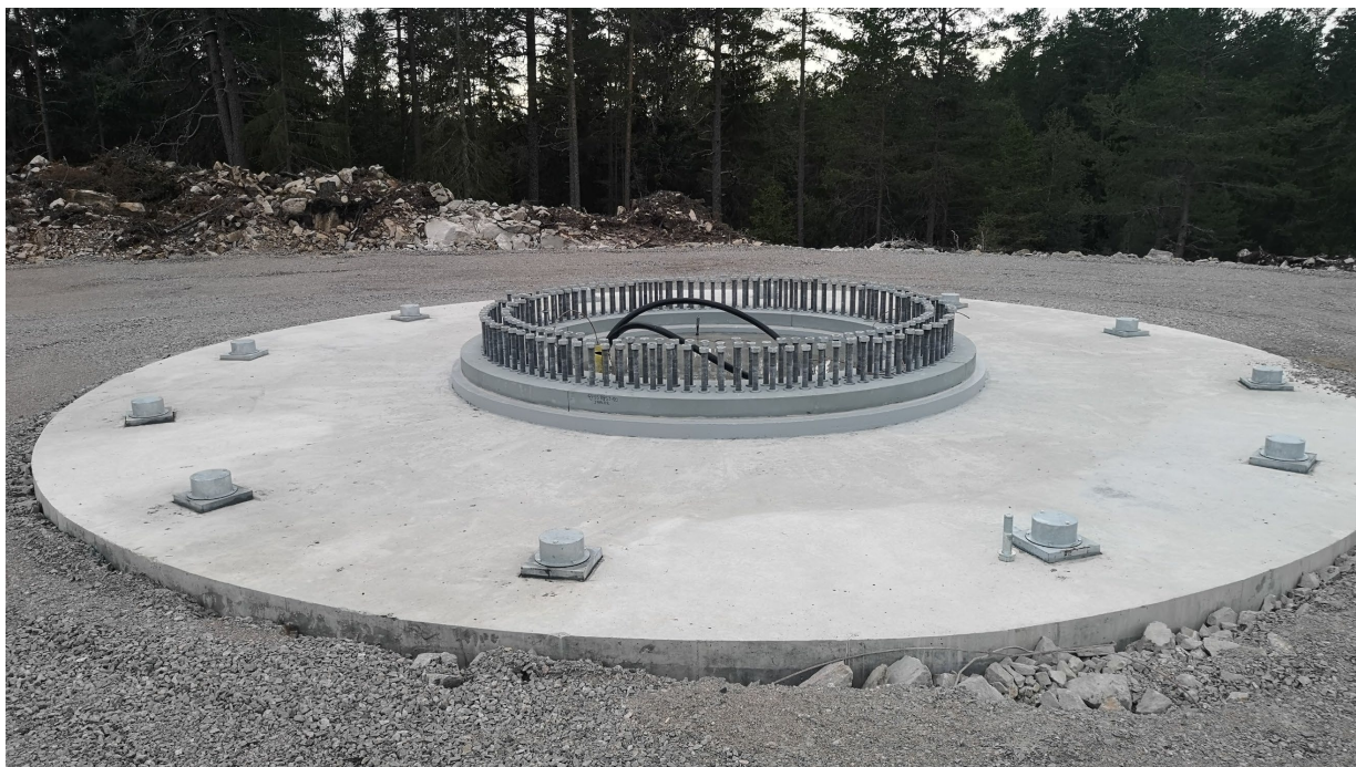
Figur 6 Eurowind Energy bygger bergsförankrat fundament till ett vindkraftverk, typ Siemens Gamesa SG170 med 200 m totalhöjd.
