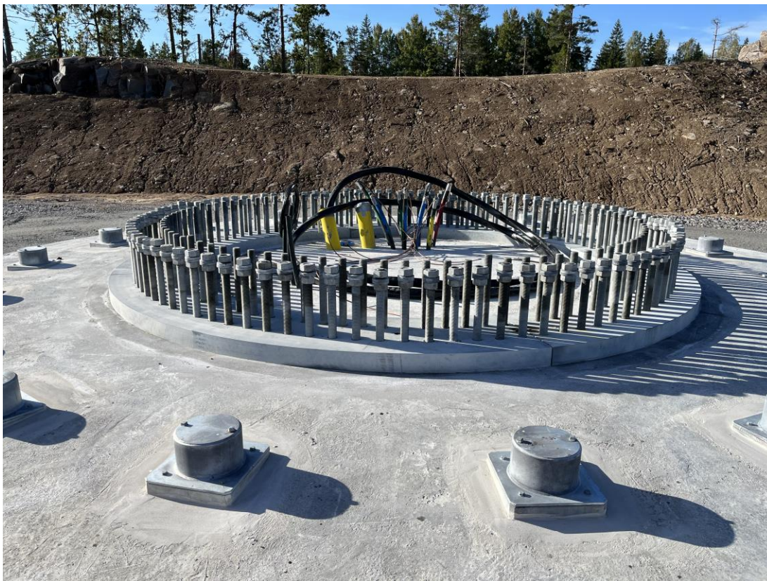
Figur 7. Byggnation av fundament. Här syns bultar för tornmontage och bergsförankring. (Foto: Eurowind).
