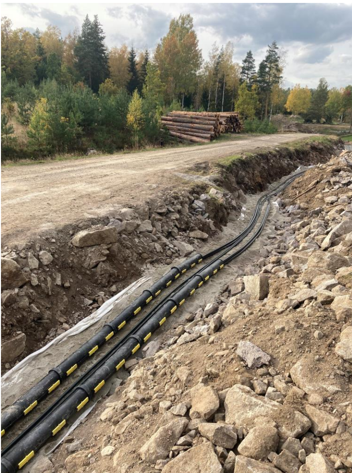
Figur 10. Kabelgrav med kraftledning och fiberkommunikationsnät intill väg (Foto: Eurowind).
